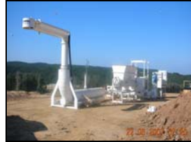
Şekil 3 . Çamur Alkali Stabilizasyon Sistemi Tesisi
